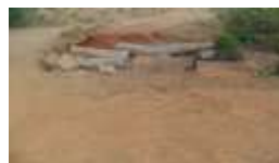
Photo 13 : buse dégradée sur la route communale à Madingring
