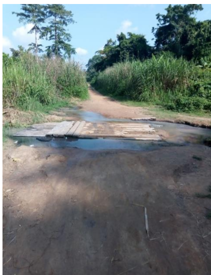
Photo 13 : Pont en mauvais état à BASSOLO
